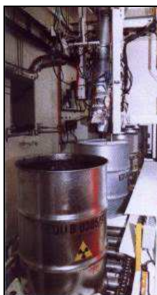
Obr. 4.5 Pohled na bitumenační linku na úpravu KRAO
