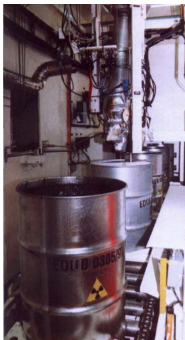
Obr. 4.6 Pohled na bitumenační linku na zpracování KRAO
