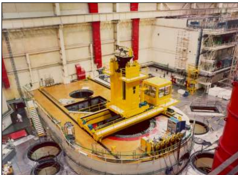
Obr. 4.1 Odkrytý BVP a ŠTK při výměně paliva v reaktoru
