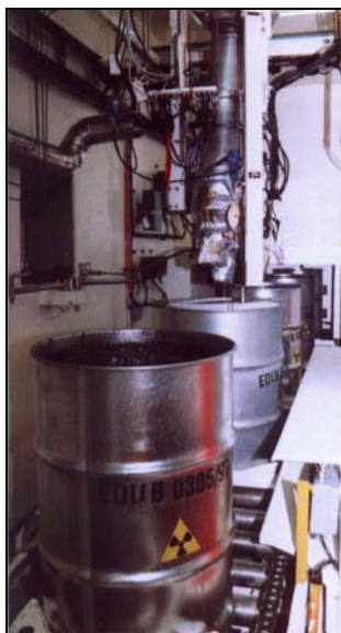
Obr. 4.5 Pohled na bitumenační linku na zpracování KRAO
