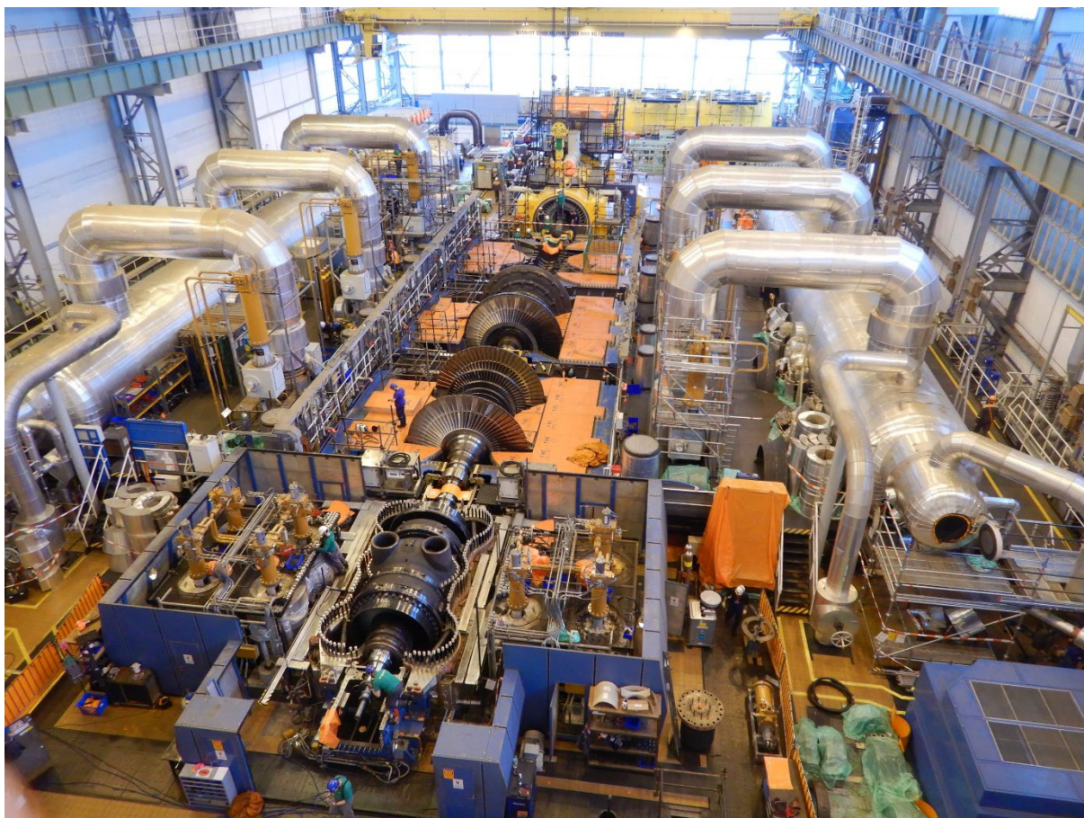
Obrázek č. 2 – Turbogenerátor Jaderné elektrárny Temelín při odstávce
